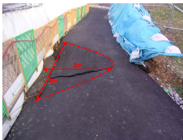
【写真－6 2 スパン目の法面崩落状況】 法面上面より撮影
