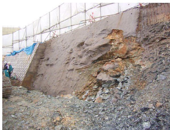
【写真－4 1スパン目の法面崩落状況】
