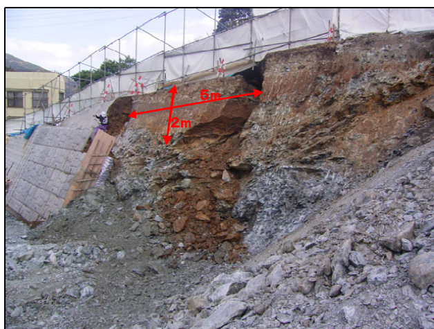
【写真－5 2 スパン目の法面崩落状況】 法面前面より撮影
