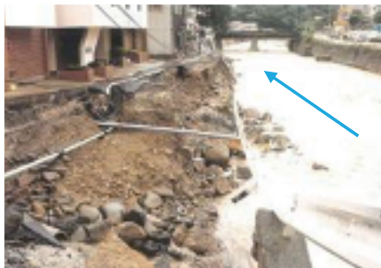
長崎大水害（S57.7.23）の被災状況
