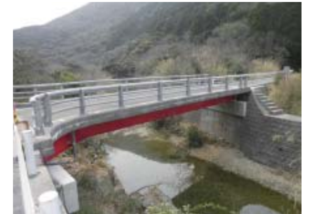
一般県道 河務福江線(宇里橋)落橋防止
