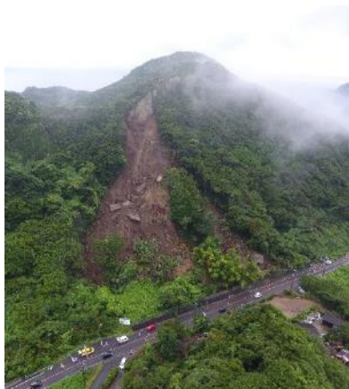
写真-1 県道隣接斜面崩壊状況
