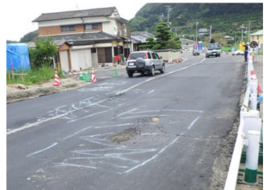
写真-1 2次施工後の路面損傷状況
