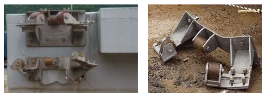
写真-4: ローラー架台損傷状況
