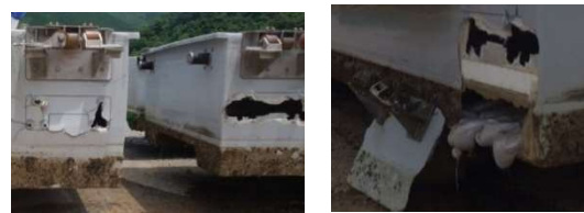
写真-5: 浮体本体損傷状況
