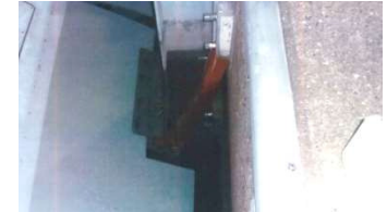
写真-2：事故当時の角材が挟まった状況
