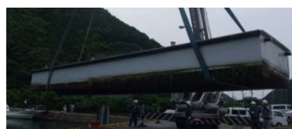
写真-6: 破損した浮体の吊上げ状況
