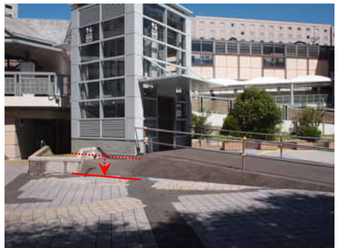
大きな段差を生じたままの駅前広場
