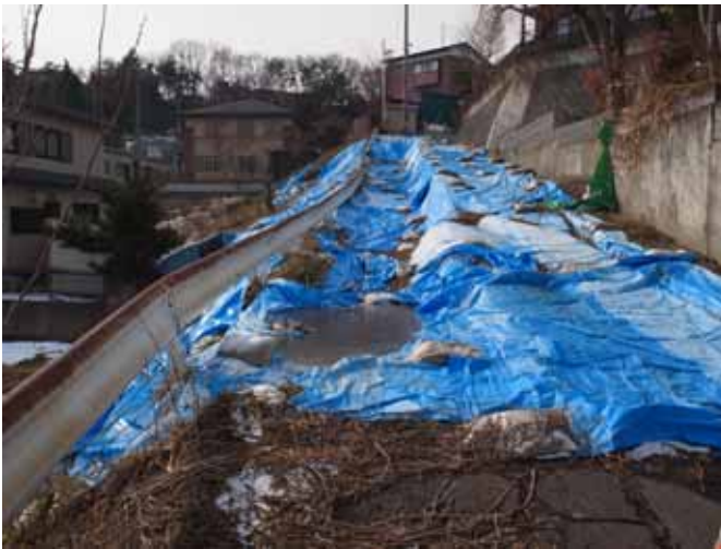
地滑りし、崩壊したままの道路
