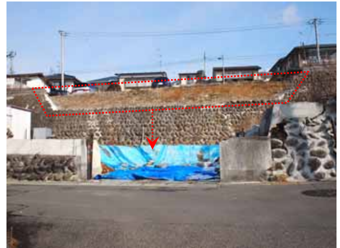
倒壊し、隣の宅地へ落ちている擁壁
