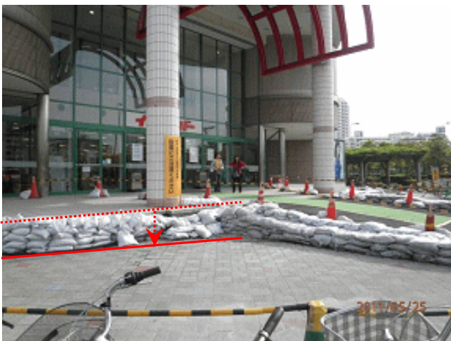
大きな段差を生じたままの商業施設
