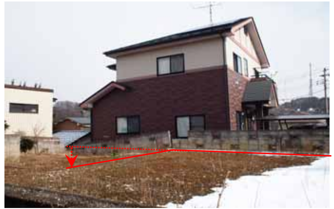
地盤がすべり、傾いたままの住宅
