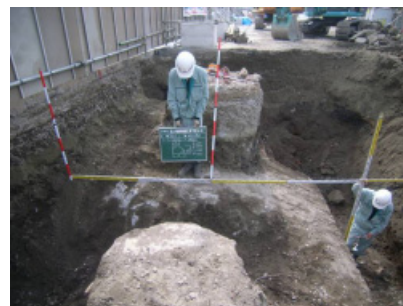
写真-2 地下障害物（建物基礎）
