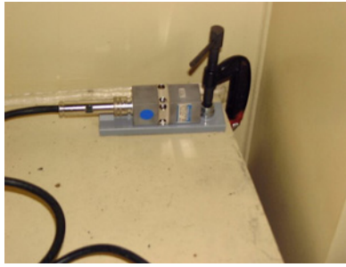
図 5-1 主塔加速度計設置状況
