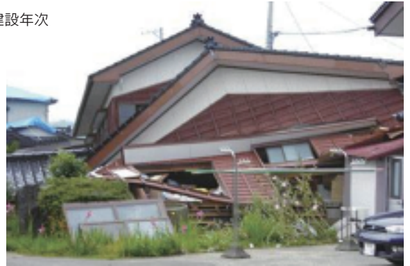
地震により倒壊した住宅
